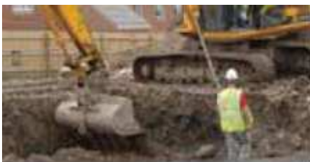
El árido es extendido sobre la geomalla triaxial antes de la compactación
